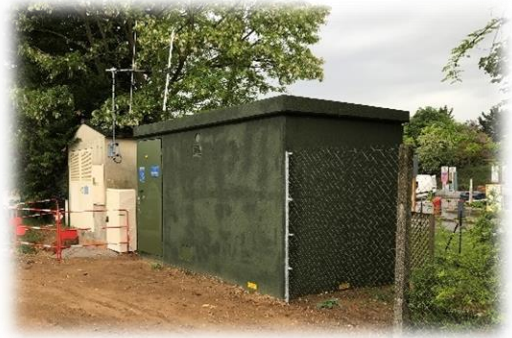
Figure 9 : Poste de livraison (Crédit photo : SERGIES, 2015)
