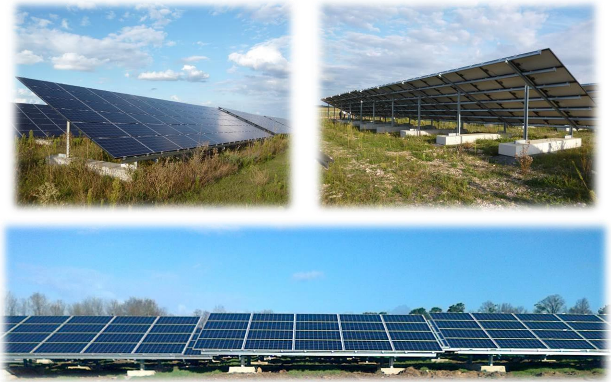
Figure 4 : Installations en fonctionnement
