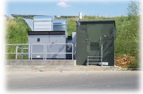
Figure 7 : Poste de transformation (Crédit photo : SERGIES, 2017)
